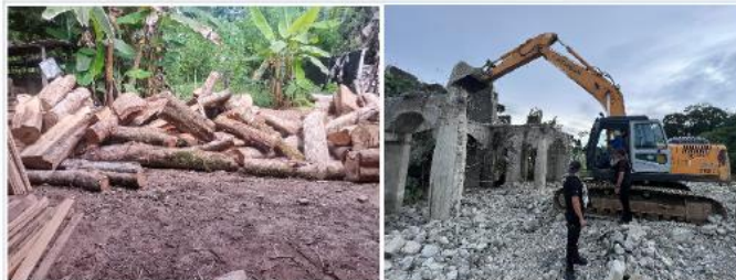
Imágenes correspondientes a las operaciones ejecutadas en el sector de Puerto Jiménez y Puerto Limón, respectivamente.
