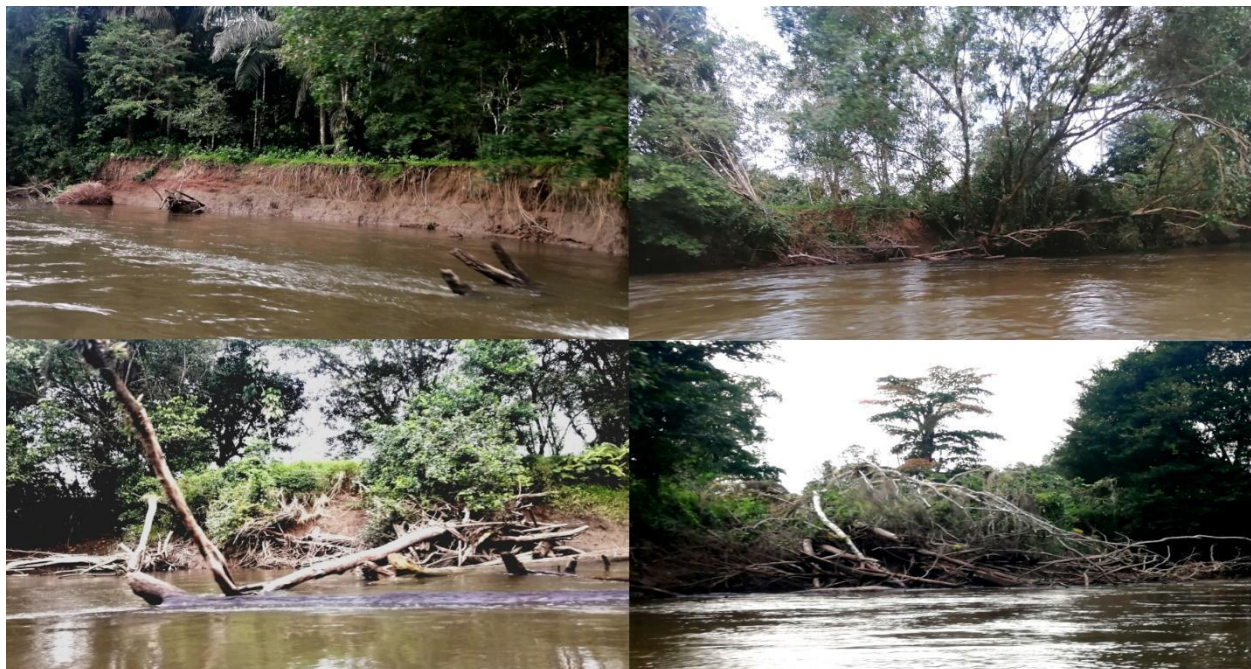
Figura 23. Erosión acelerada y socavamiento de árboles en el Río Parismina, entre la boca del Río Silencio y la confluencia con el Río Jiménez. Fuente: elaboración propia.
